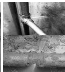
Sistema de extinção de incêndios
