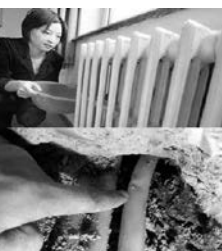
Tubos de aquecimento/fugas nos tubos de aquecimento por baixo do pavimento
